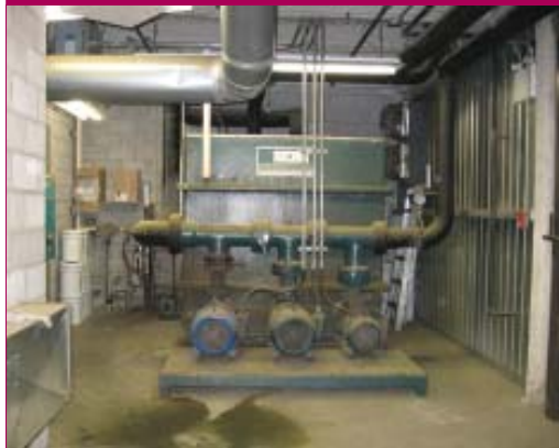
Tour de refroidissement
