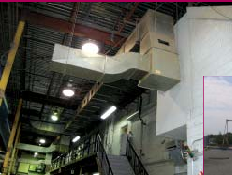
Conduites de ventilation
